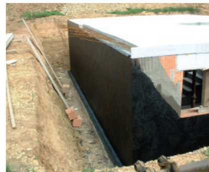
Abdichtung einer Kelleraußenwand aus Beton mit PCI Pecimor 2K. Geschmeidig-leichtes Verarbeiten durch Polystyrolfüllung.
