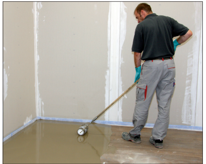
8 Mit einer Stachelwalze wird die aufgebraute Spachtelmasse verteilt und verdichtet, um eine planebene Oberfläche zu erhalten.
