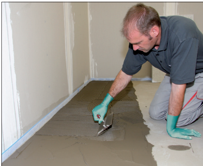
9 Nach Trocknung der Spachtelmasse wird auf den planebenen Untergrund z. B. Sopro's No.1 Flexkleber aufgetragen.
